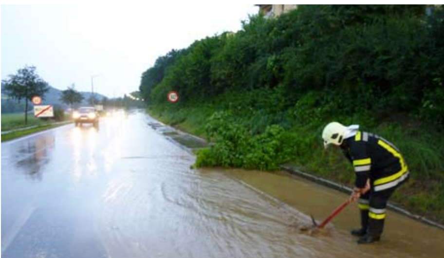
Reinigung der verstopften Abwasserrinne neben der B129
